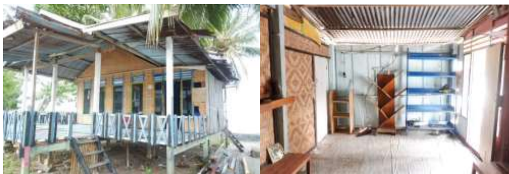
Gambar 1. Kondisi awal perpustakaan
